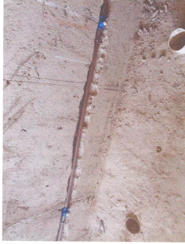
Tubulação e pontos de hidráulica
