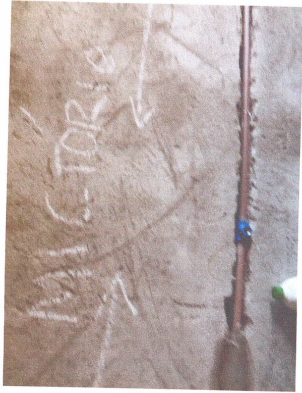
Tubulação e pontos de hidráulica
