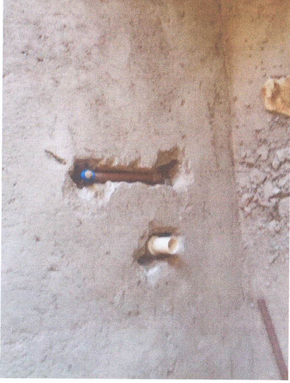
Ponto água e esgoto
