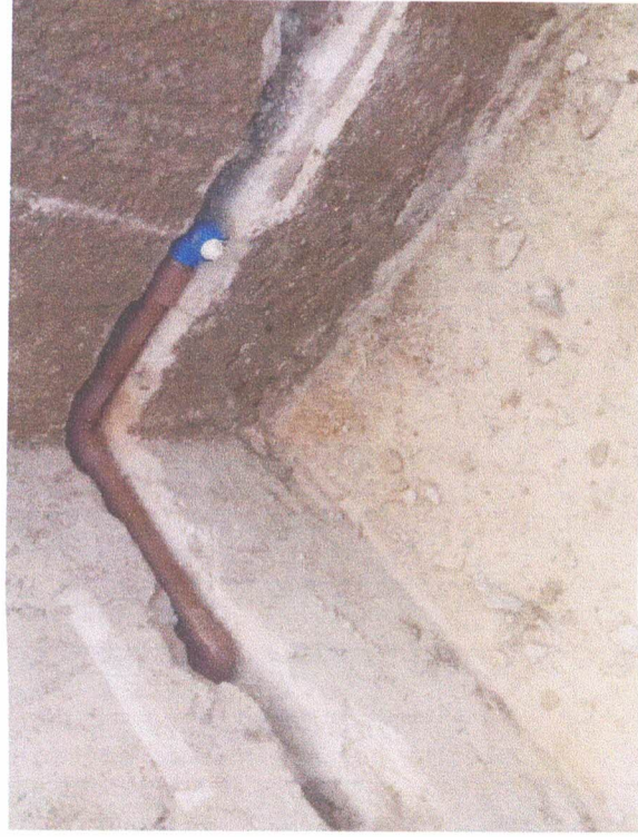
Tubulação e pontos de hidráulica
